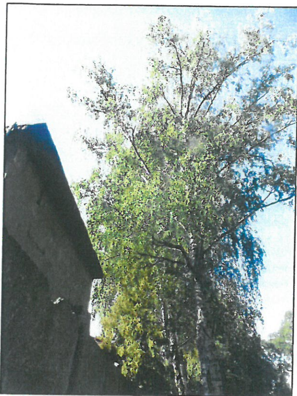
Zdj. 5. Korona drzewa sięgająca na budynek sąsiedniej działki
